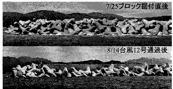
図20 室津港沖防波堤Iでの消波ブロック沈下時の状態(被災時の波高は設計波より小さかった)(鈴木ら, 2002)
