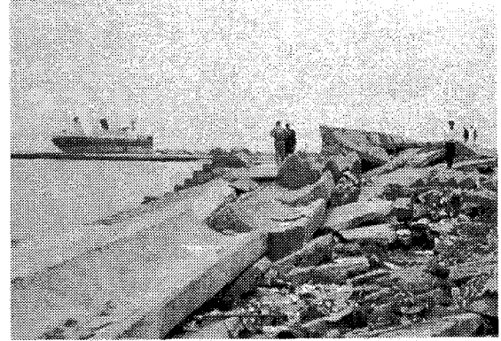
写真5 波力による海岸堤防の破壊 7)
