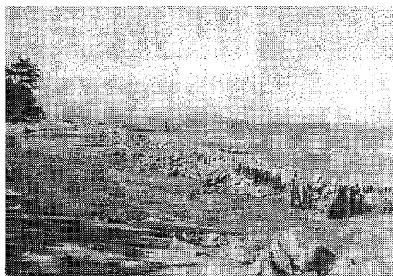
写真3 三重県明和町の海岸堤防の破堤 5) (1953年台風13号による)
