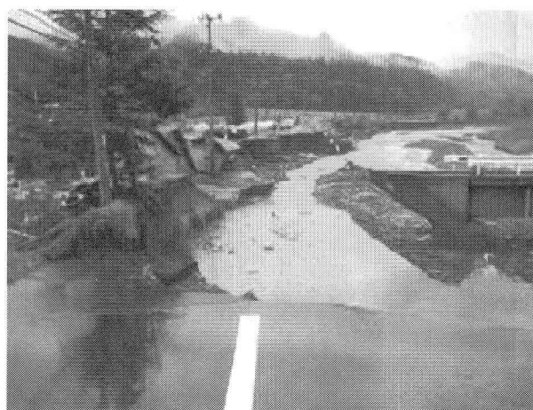
図-28 橋梁の被災状況(その3) 7)
