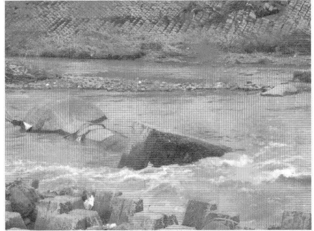
図-42 足羽川第一鉄橋の倒壊状況 14)
