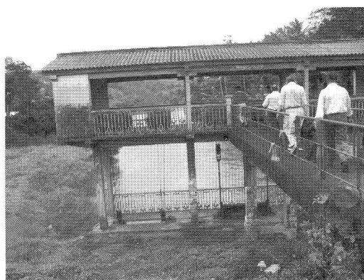
図-11 内水氾濫対策用のポンプ場 4)
