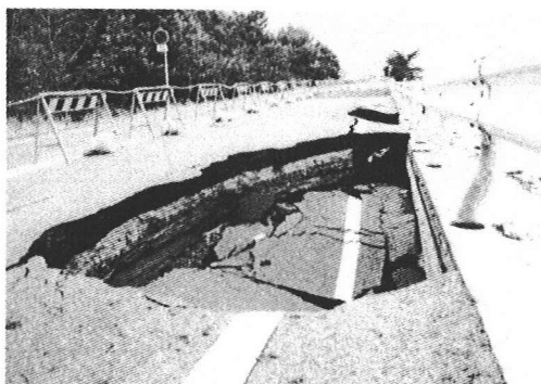
写真-7 護岸裏込め土砂の流出による被災
