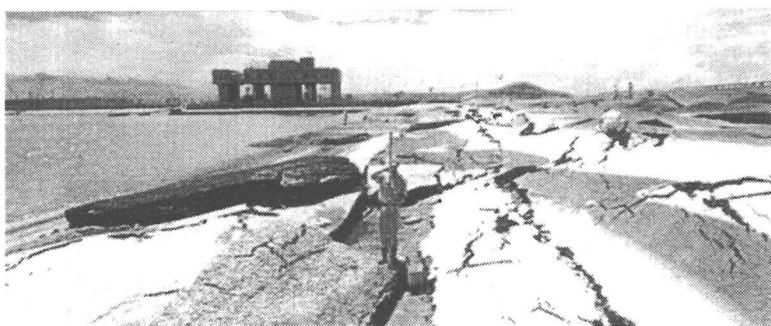
図－7 落差流に伴う揚圧力による被災事例
