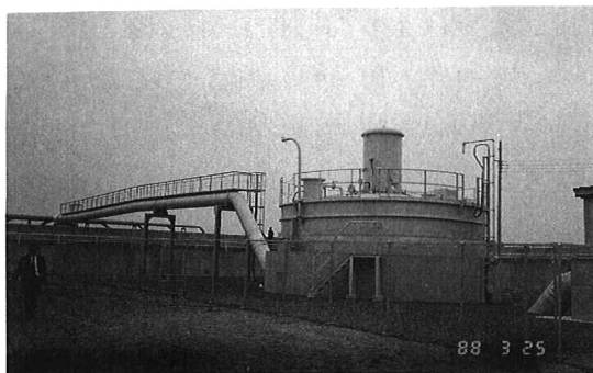
図-14 空気タービン式波浪発電用定圧化タンク (千葉貝漁港)
