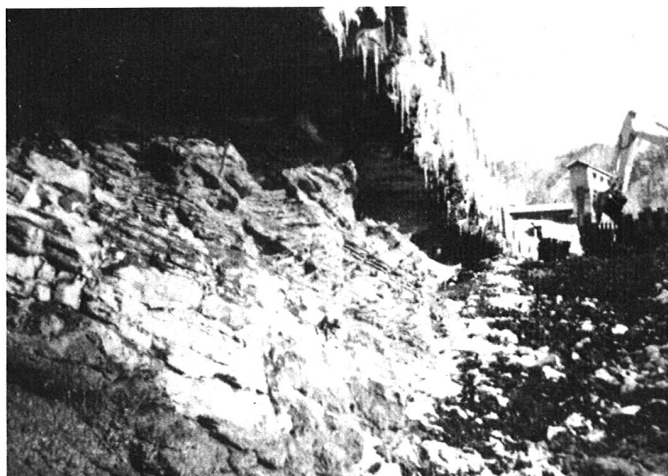
写真－7 北空知頭首工下流の護床工の損壊 (S.56年豪雨災・災害復旧事業概要書 8) から)
