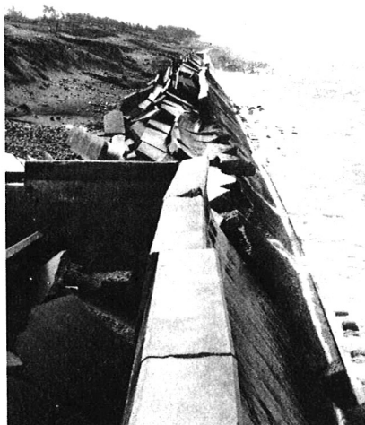
図-23 バットレス護岸被災(その1)
