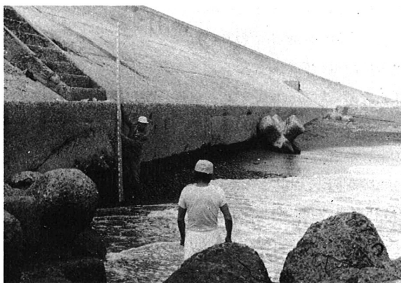
図－8 基礎矢板露出（昭43年6月14日）
