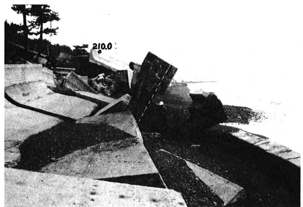
図-13 前浜のせまい所は破堤した
