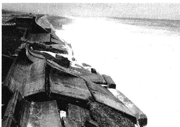
図－9 ついに破堤（昭43年7月25日）
