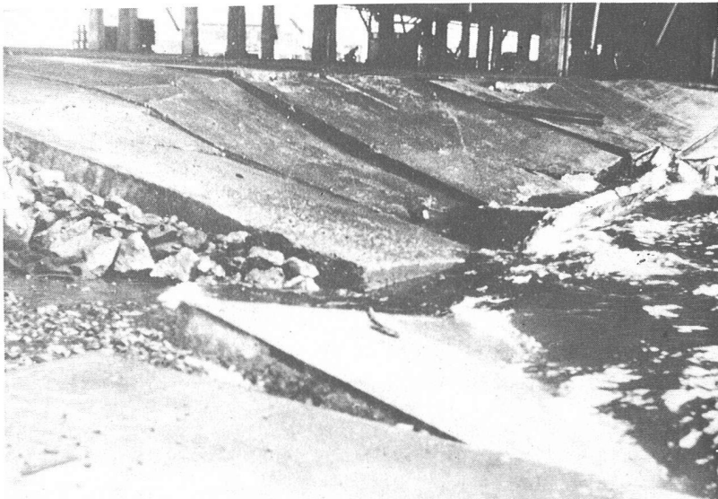
写真-10 八戸小中野岸壁の倒壊
