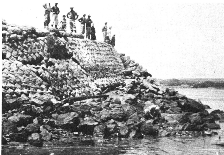
写真-11 松島湾入口小乗浜石垣のズレ下り
