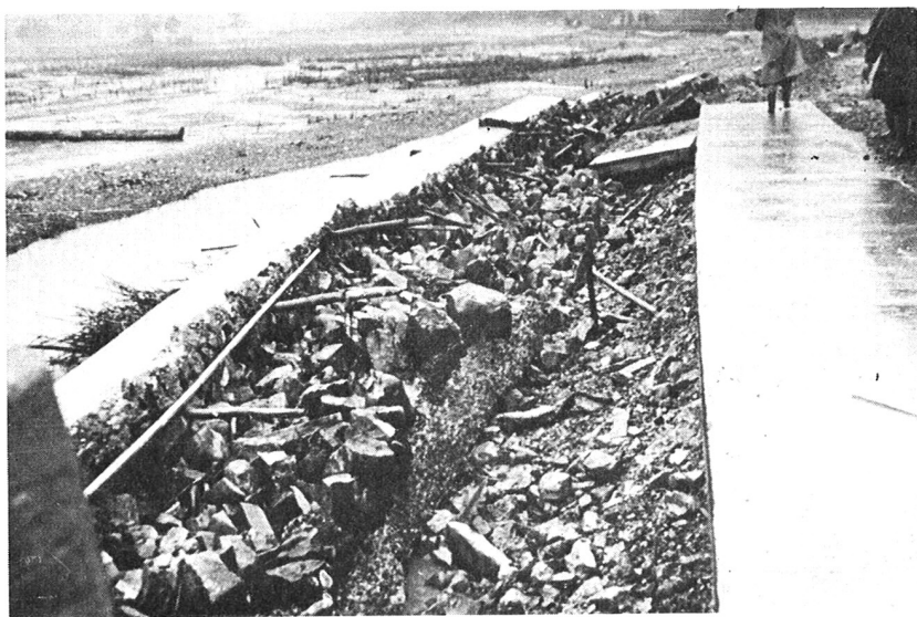
写真-13 志津川惨波伝谷・水戸辺間護岸欠損
