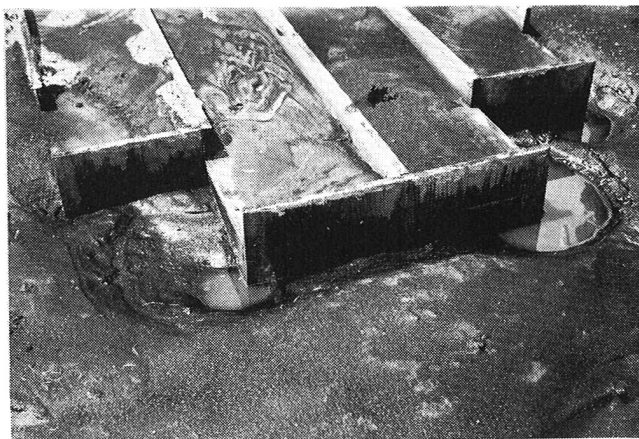
写真- 3 暗渠前面の洗堀状況（実験 6）
