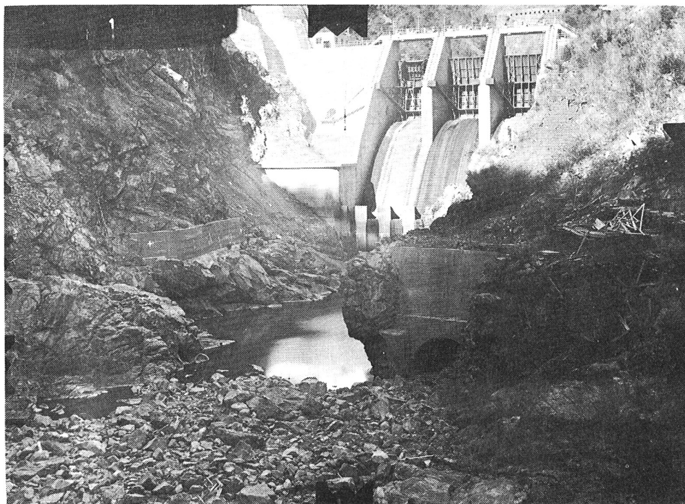
第9図 奥泉ダム下流の洗堀状態
