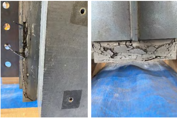
図-11 加熱後における試験体の損傷状況(A-3)
