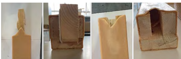
写真-6 手加工の破壊状況(P-I-1)
