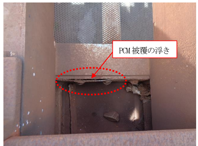
(c) 下り線桁PCM被覆の浮き
