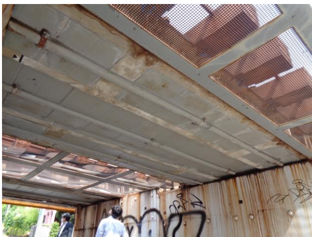
(b) 下り線桁下面（複合構造化後9年経過）
