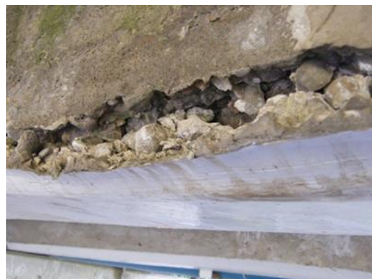
写真-5 G1主桁の浮きの詳細
