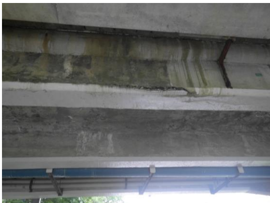
写真-4 G1主桁の浮き
