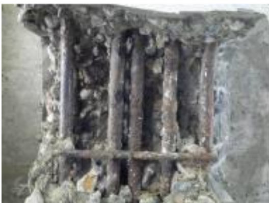
写真-6 G1主桁の鉄筋径の減少
