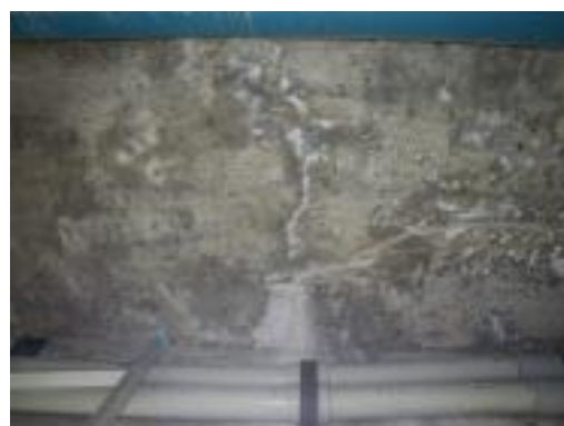
写真-3 床版下面の状況（遊離石灰）
