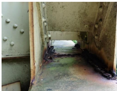
図-1 ガセットプレート腐食事例（ガセット内側）
