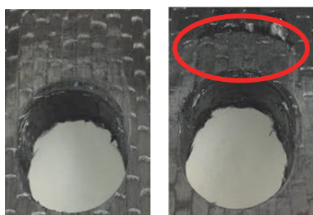
図-12 実験後のボルト孔の外観 (左：2面 J1HD1，右：1面 J1HS1)
