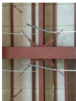
写真4 屋根ブレースの破断
