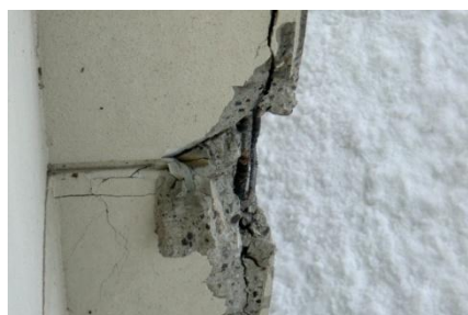
写真3 SRC柱脚部の損傷
