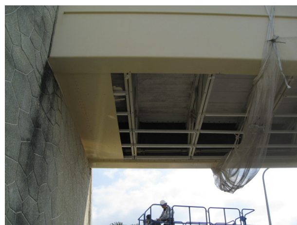
図-4 P1付近のGFRPパネルの状況
