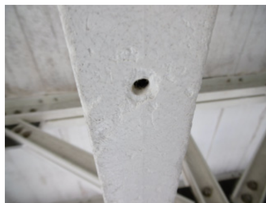
図-5 ブラインドリベットが引き抜かれた箇所の例
