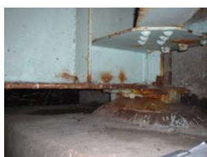
写真-1.2 支承の腐食
