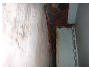
写真-1.1 伸縮装置の漏水
