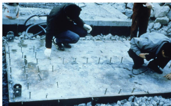
写真-1 スタッド破断状況
