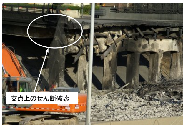
写真-2 落橋後の支持桁および吊材の状況
