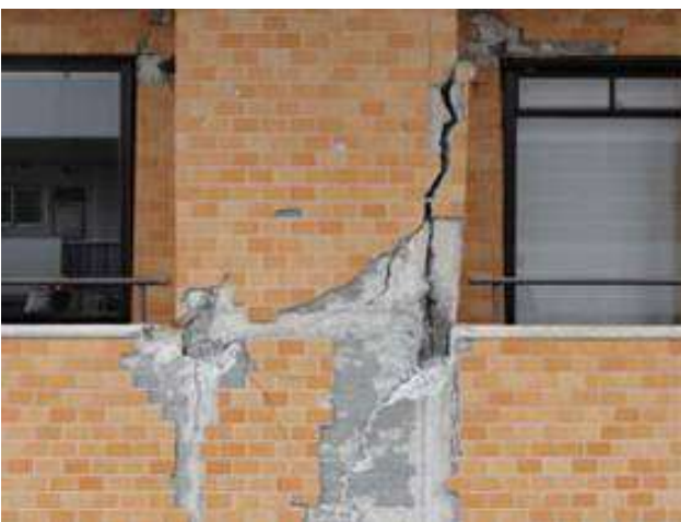
写真. 3 1階柱のせん断ひび割れ
