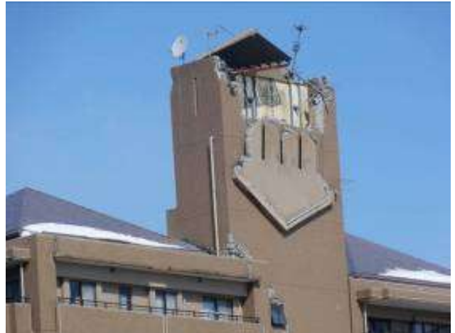
写真 11 塔屋部の損傷
