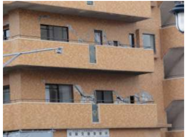
写真. 4 非構造壁のせん断破壊
