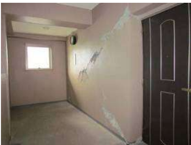
写真. 10 RC 耐震壁のせん断ひび割れ 4)
