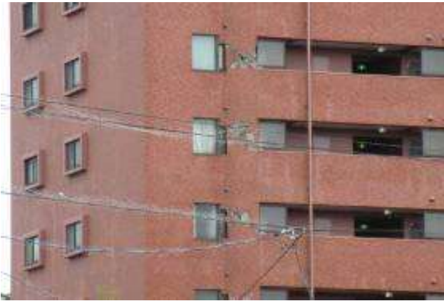
写真. 1 非構造壁のせん断破壊
