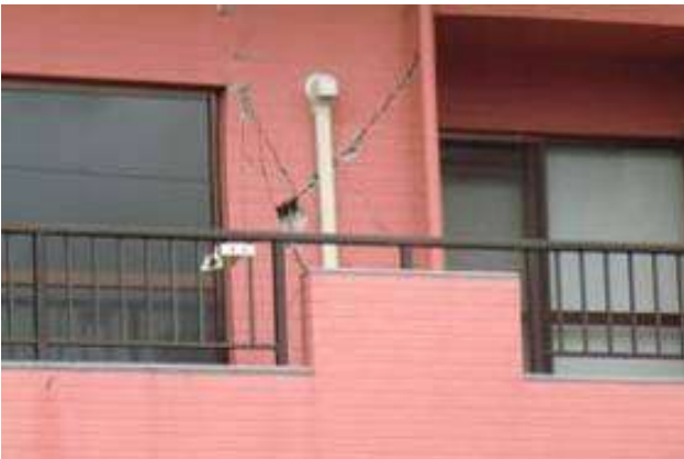
写真. 2 非構造壁のせん断破壊
