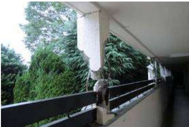
写真. 8 間柱のせん断ひび割れ
