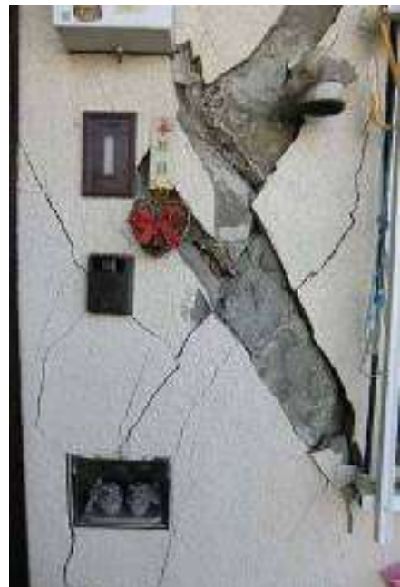
写真. 12 非構造壁のせん断破壊
