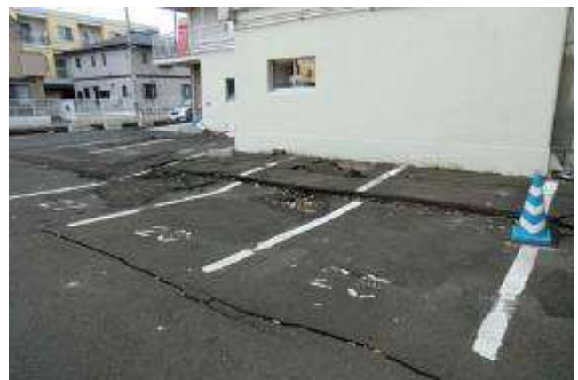
写真. 6 地盤沈下による建物周辺部への被害
