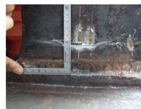
(c) フランジ下面からみた亀裂 (R33C-PA13-S-S)
