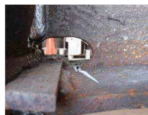
(b) スカラップに生じた亀裂 (R33C-PA13-S-S)
