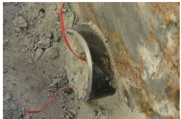
写真-2 鋼パイプの変形
