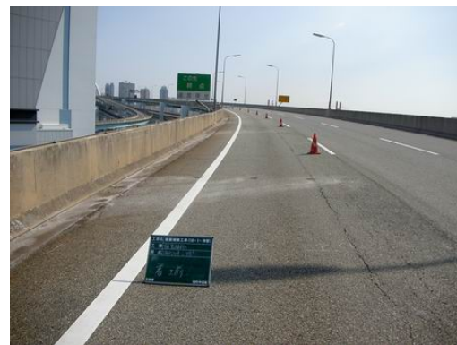
写真 4. グースアスファルトのひび割れ
