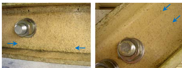
図-13 FRPのクラック
