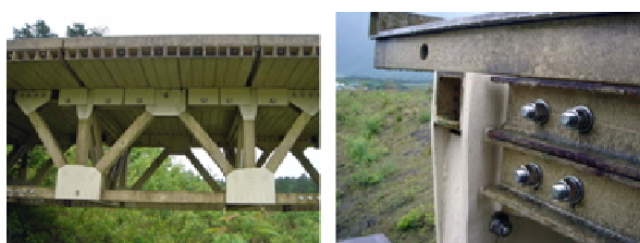
図-12 FRP表面の汚れ
