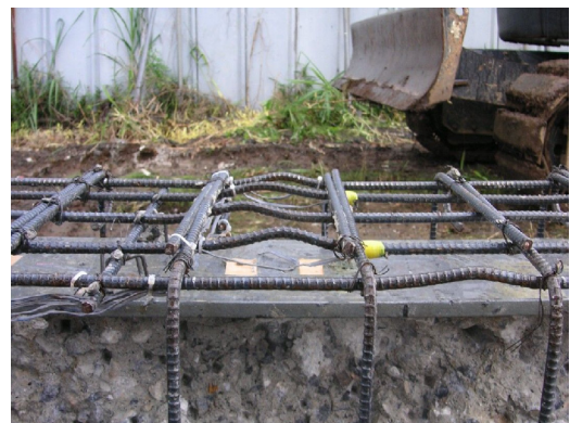
写真-3 圧縮鉄筋座屈、鉄骨上フランジ状況 コンクリートはつり後 (SRCNo.2)
