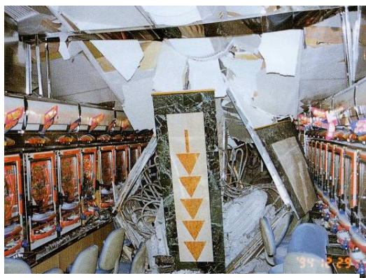
写真-1・1 三陸はるか沖地震によるパチンコ店のRC中壁のX型のせん断亀裂
