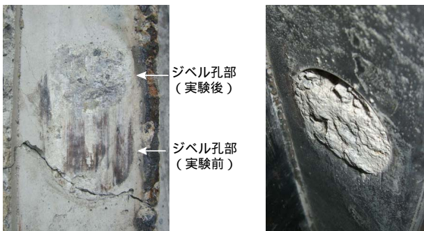
写真-3 実験後のジベル孔周辺の様子
