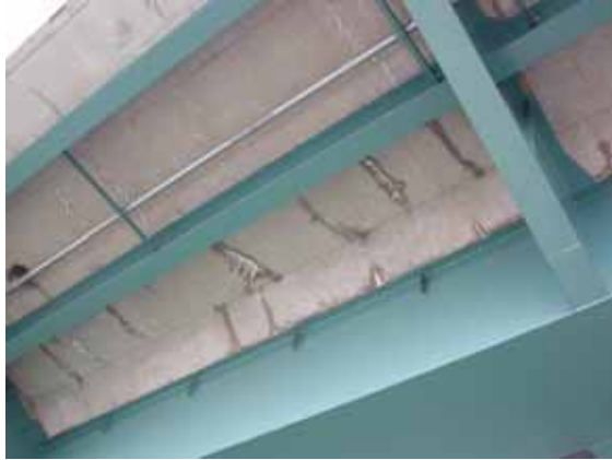
写真-1 下路式アーチ橋の床版下面ひび割れ状況の例
