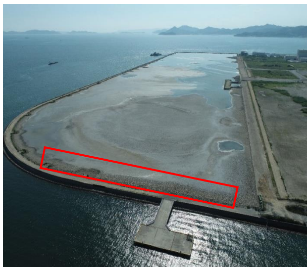
図-8 漏水が確認された場所
