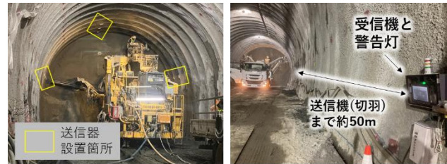
送信機 設置状況
