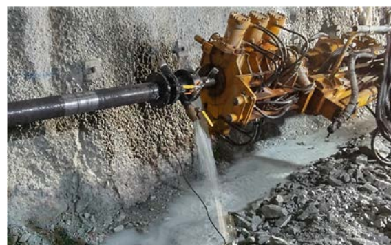
写真-1 先進ボーリング口元からの湧水状況
