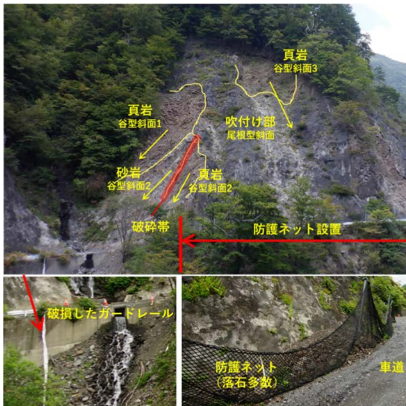
写真-2 斜面の地質構造，黄色矢印は斜面の方向を示す（上），ガードレールの破損（左下），防護ネットの設置状況（右下）
