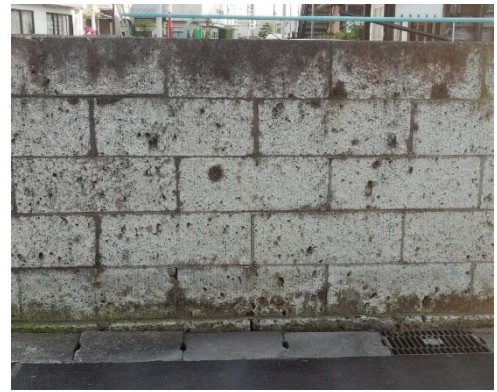
図-1 色調が変化し最下段の石材が剥離した大谷石擁壁
