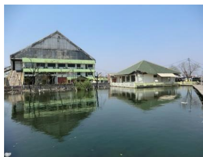
(b) 沈下により浸水、放棄された建物
