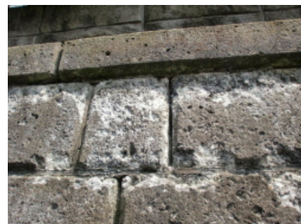
図-3 剥離した擁壁
