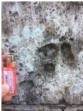
図-1 大谷石のミソ部分の剥離の様子
