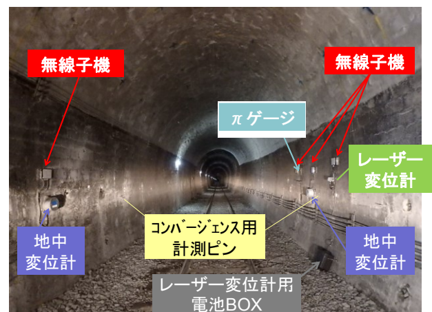
図-8 モニタリング機器設置状況 (全体写真)
