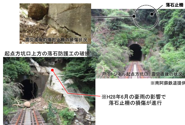
写真-1 戸下トンネル入口の被災状況
