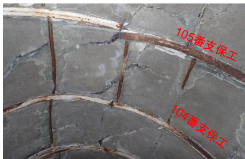
写真-2 105番支保工付近の天端部の変状 3)
