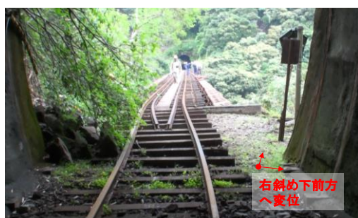
写真-3 犀角山トンネル出口方坑口部の変位状況
