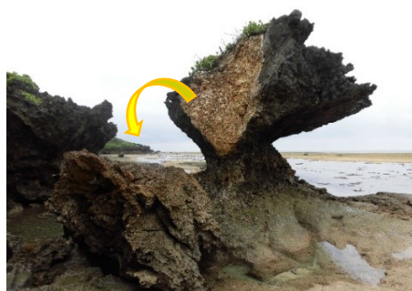
(b) 最近崩壊した備瀬崎周辺の海食崖そのⅠ (図-1の②地点)
