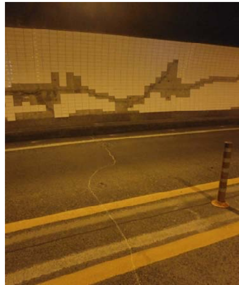
写真-1 側壁と路面に生じたひび割れ
