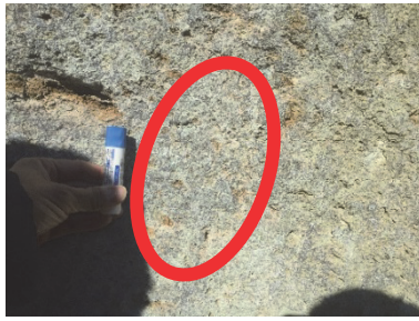
図-4 空洞化した壁面(赤丸内で空洞化)
