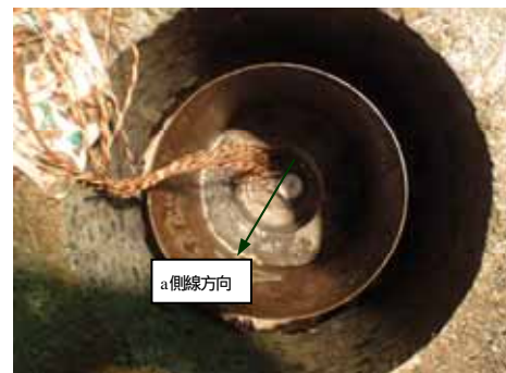
写真-1 コアセンサー設置状況(No.2)
