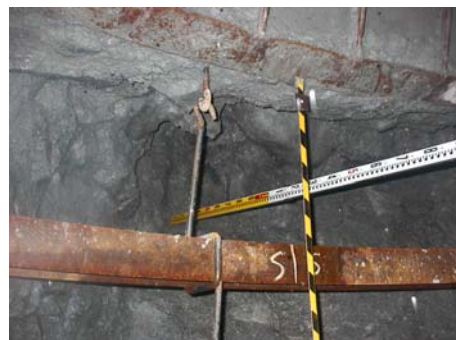
写真-5.1 花崗岩礫の崩落箇所
