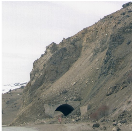
図-3 1939 Erzincan地震による道路トンネルの被害 7, 9)
