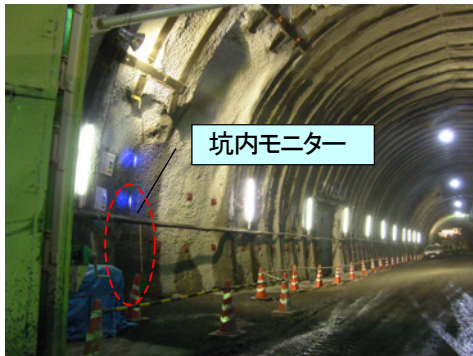
写真-13 LEDSによる坑口斜面監視適用現場の状況(2)
