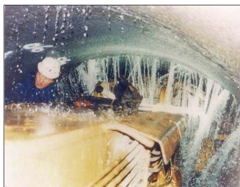
写真-5 トンネル内湧水状況
