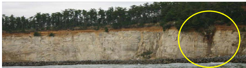
図-14 南側で最も崩落危険度の高い地点
