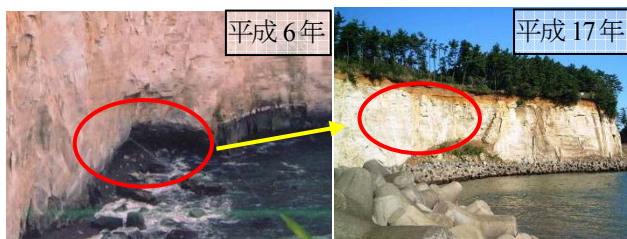
図-15 ノッチの充填を行わないと崩落の危険性がある
