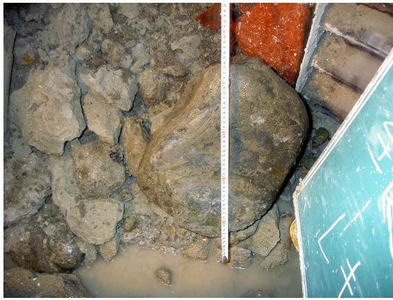
写真-5 中間貫通立坑構築時に摘出された巨石
