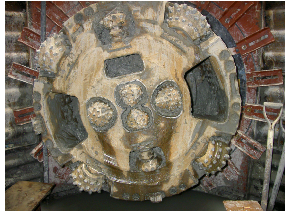
写真-7 中間貫通立坑におけるカッタービット磨耗状況
